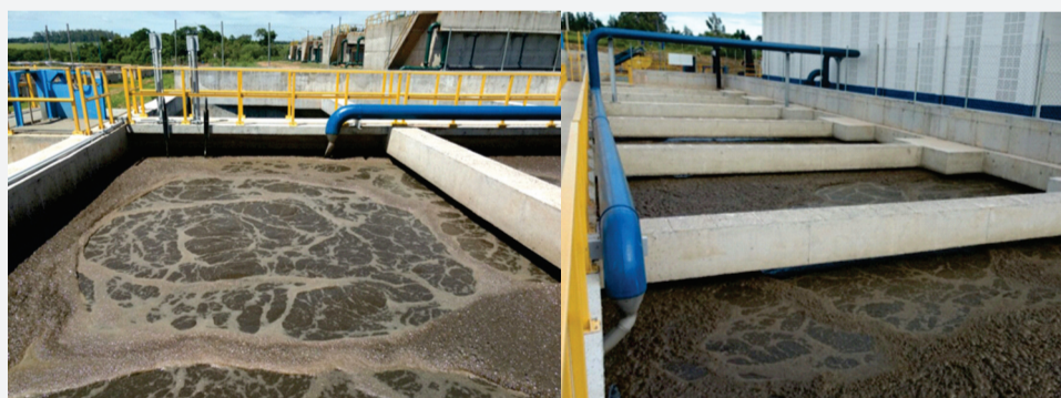
Tanque de Aeração
