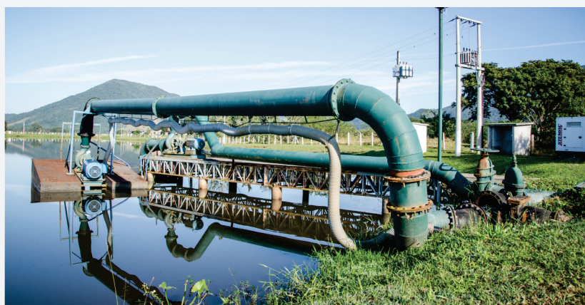
Lagoa de Reservação de água bruta
