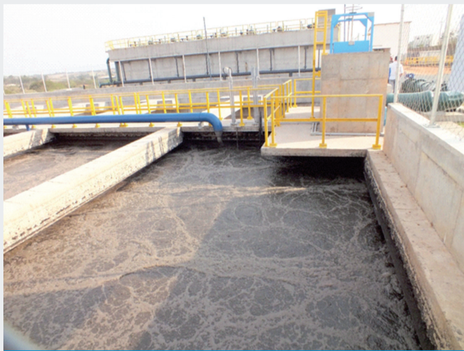
Operação na ETE Santa Isabel
