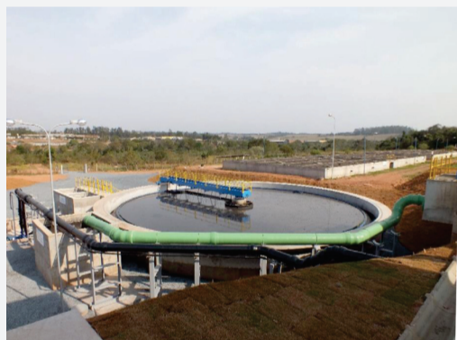
Decantador do sistema de lodos ativados na ETE Santa Isabel
