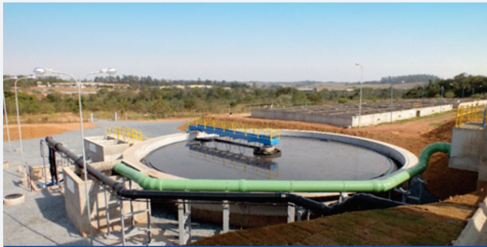
Decantador secundário do sistema de lodos ativados na ETE Santa Isabel
