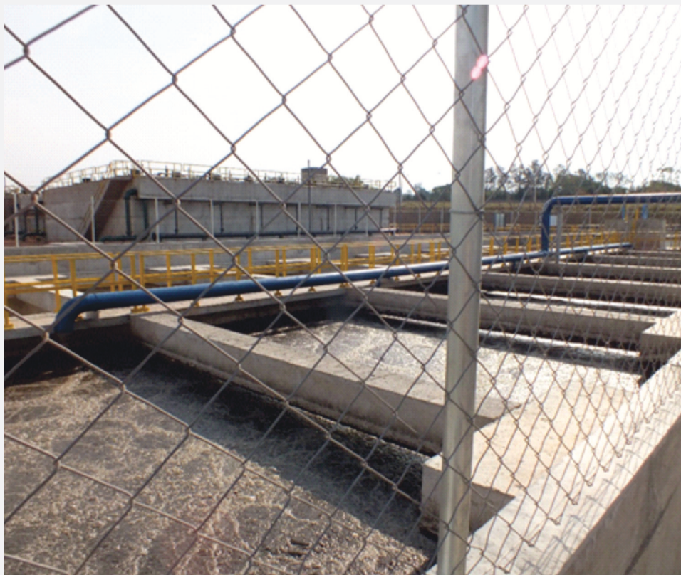
Tanque de Aeração ETE Santa Isabel
